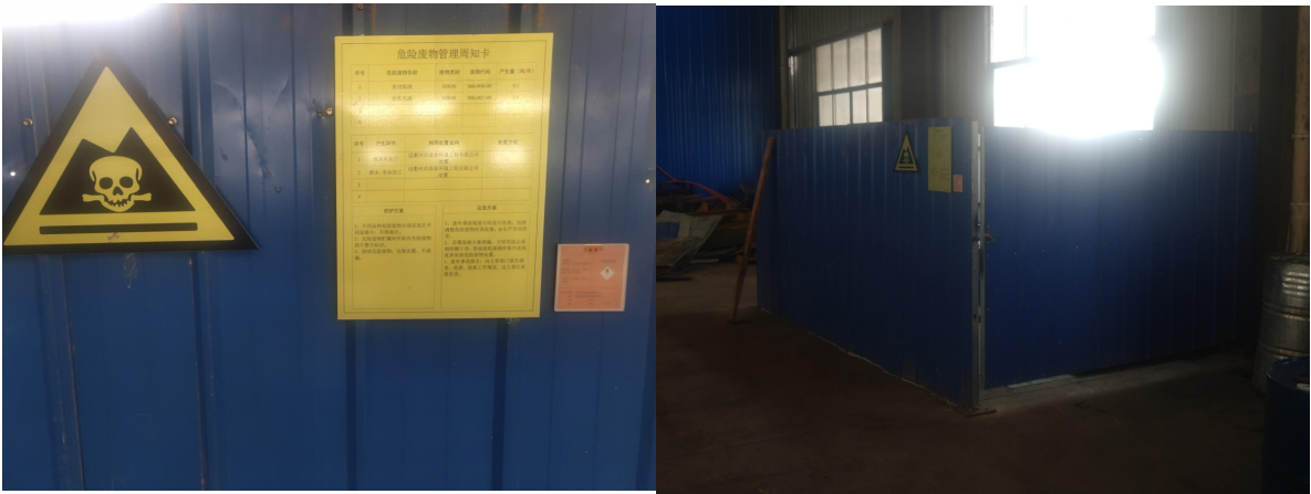
图3-2 项目危废暂存间
